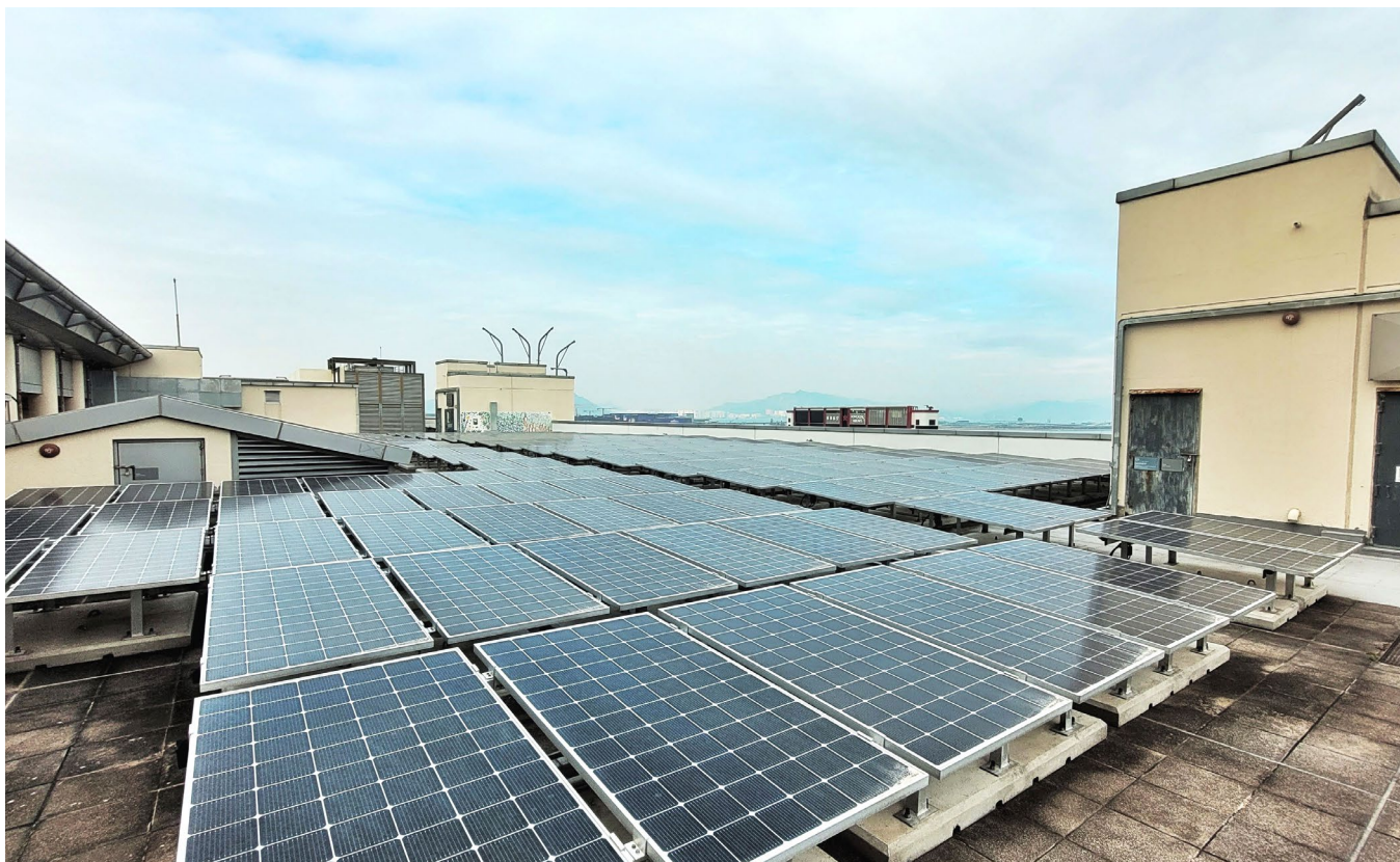
我們於國泰城總部大樓的天台增設太陽能發電板
